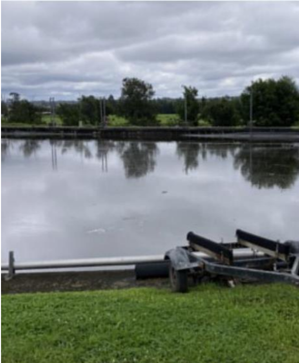
EPA 19 – Effluent Pond 1
