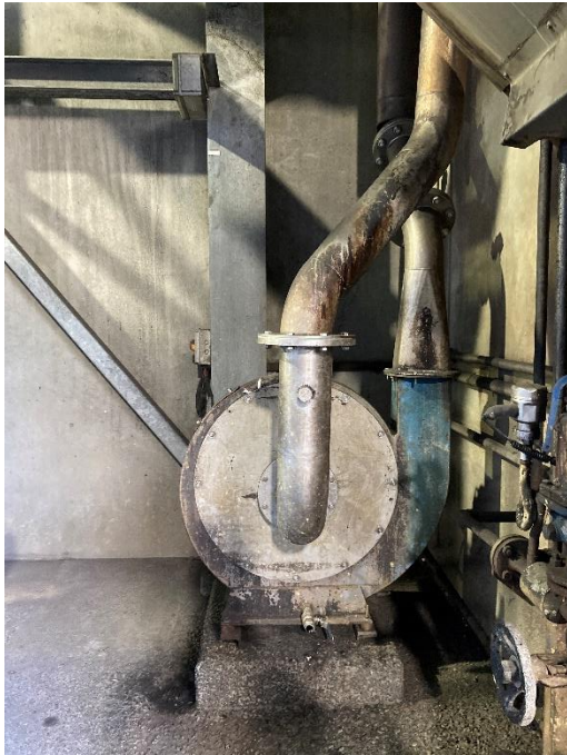
DDG 3 – Air Leakage Fan
