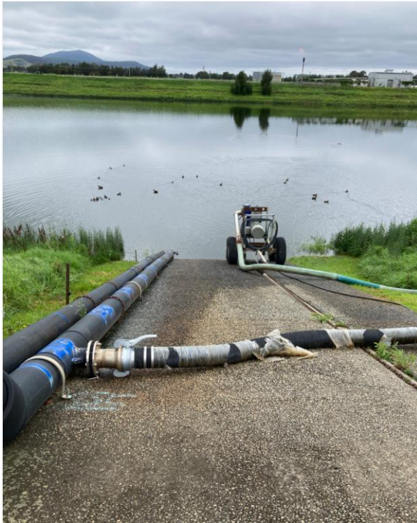
EPA 23 – Effluent Pond 5
