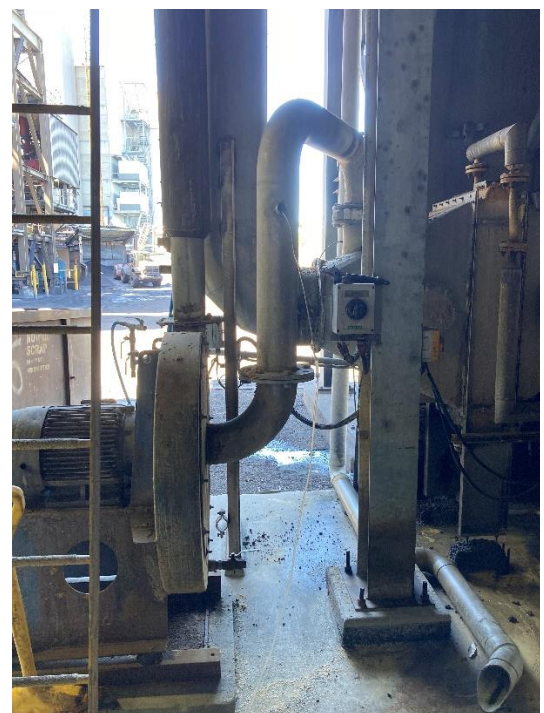
DDG Dryer 1 & 2 – Air Leakage Fan
