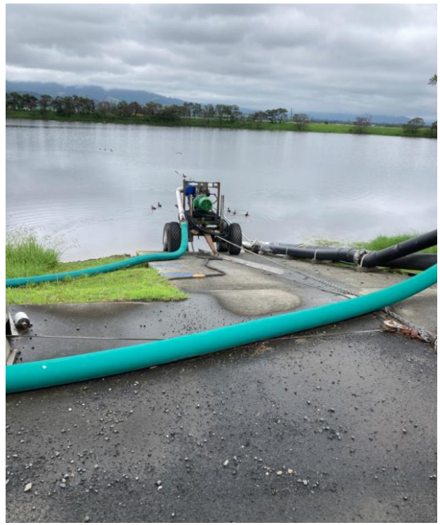
EPA 24 – Effluent Pond 6
